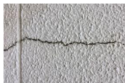
外壁のひび割れ★★★★
