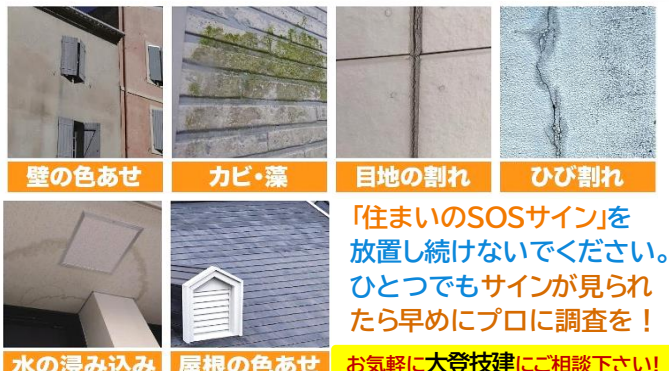
壁の色あせ | カビ・藻 | 目地の割れ | ひび割れ
