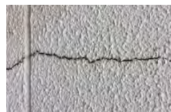
外壁のひび割れ★★★★
