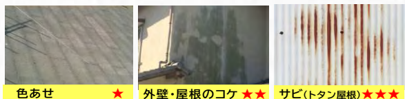
色あせ ★ 外壁・屋根のコケ★★ サビ(トタン屋根)★★★
